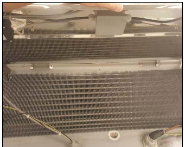
Fig. 14 Fan and Fan Plenum
